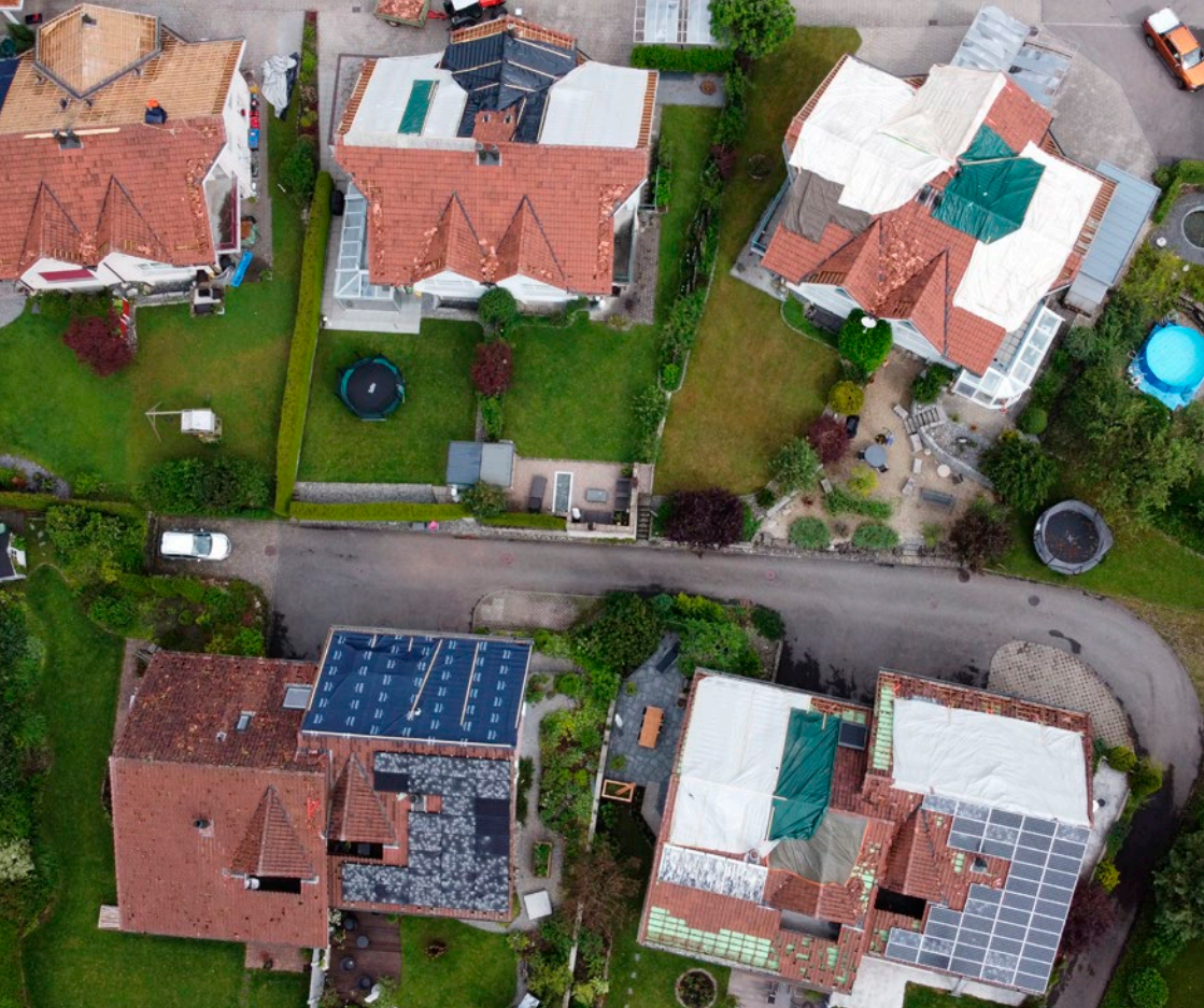
Der Hagel beschädigt die Dächer stark, selbst Photovoltaikanlagen wurden zerstört.
